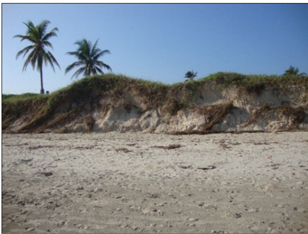
Figura 10. Escarpes en las dunas originados por el intenso oleaje del huracán Irma
