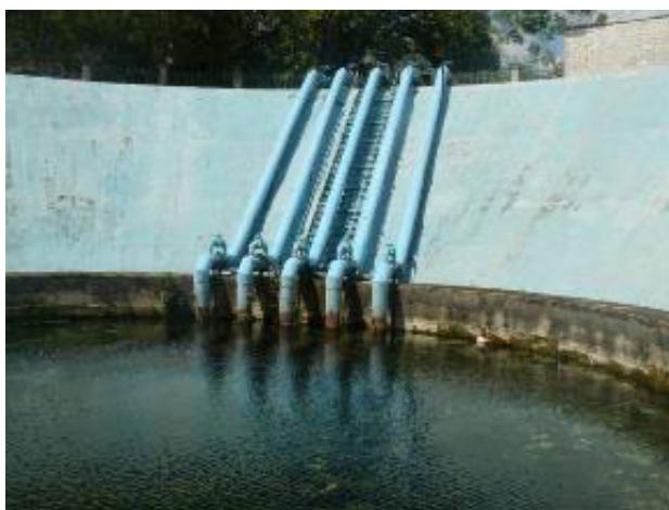
Figura 4. Taza de Vento, sistema de captación de los manantiales del acuífero libre cársico de la Cuenca de Vento donde, en algunos sectores se explotan aguas de tiempos de residencia del orden de los 100 años. Obsérvese la depresión de los niveles de descarga por el cambio de coloración de la estructura (Foto del Autor).
