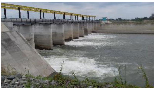
Figura 6. Trasvase Dauvín, Ecuador, derivadora para el control de inundaciones (Foto del Autor).
