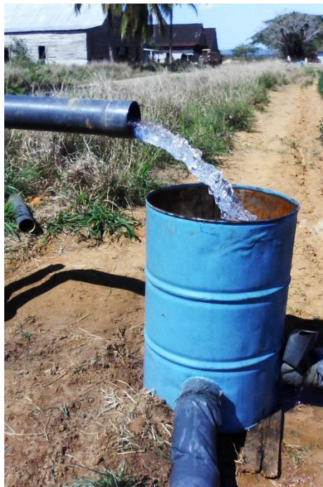
Figura 2. Hidrante de salida al campo y tanque amortiguador con conexión de las mangas de polietileno.
